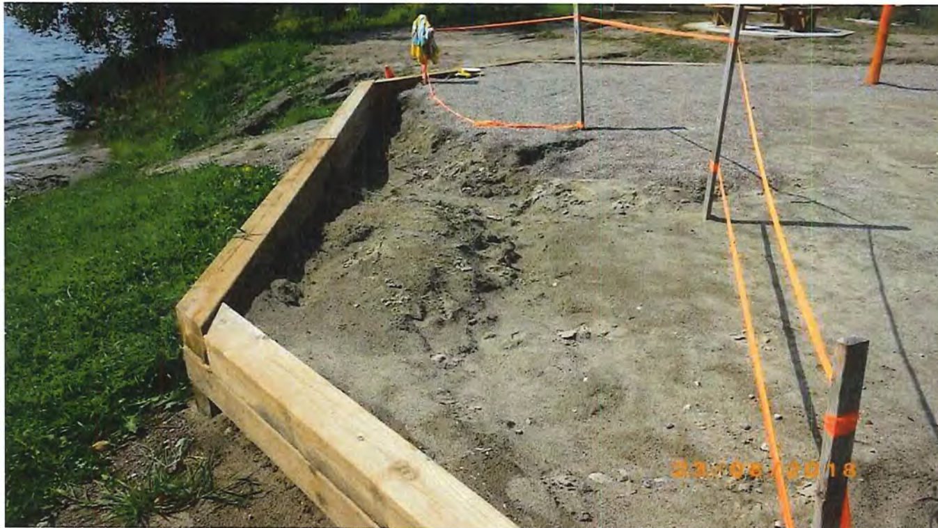
Photo 1 : Traces d'érosion à l'intérieur de l'aire de jeux pour enfants. Ruban pour signaler le danger.
