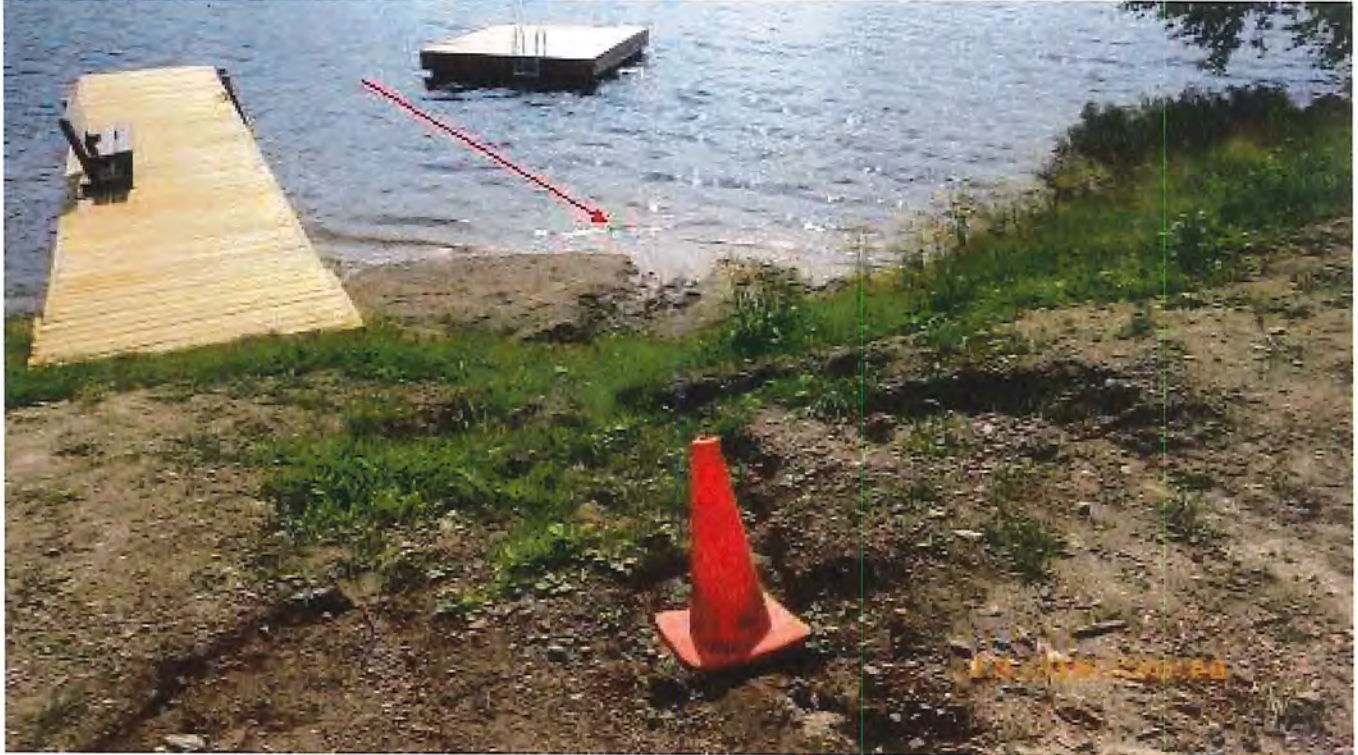
Photo 4 : Trace d'érosion qui atteint le littoral
